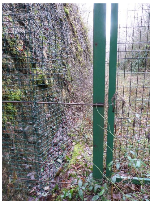
Figure 5: Dégradation du grillage, entrée sud
