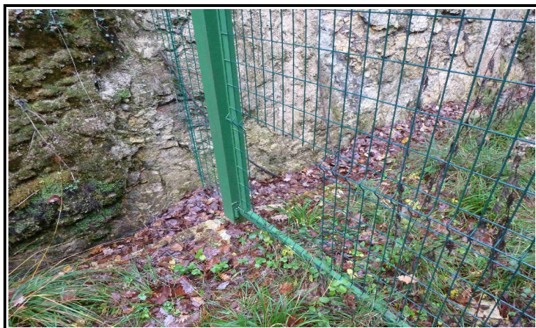
Figure 2: dégradation du périmètre grillagé
